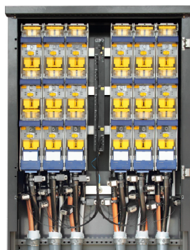
Figur 2.3: SGU Monteret i sikringsskab.
